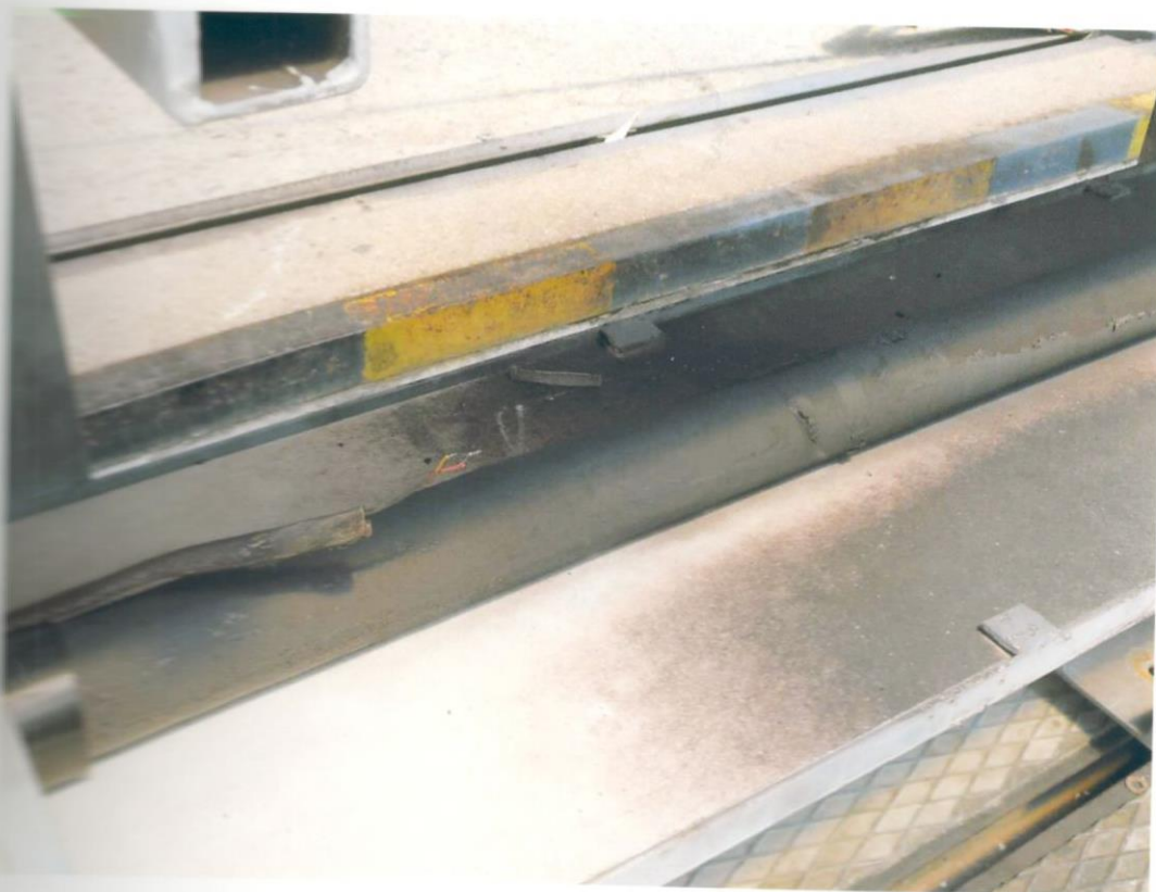
Obr. 6 Zkušební vzorek po zkoušce obloukovým zkratem na zkušebním kabelu vn - detailní pohled na kabelovou lávku pod poruchou
