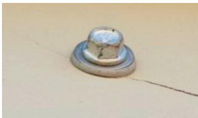
3. Špatné řešení – deformace EPDM podložky
